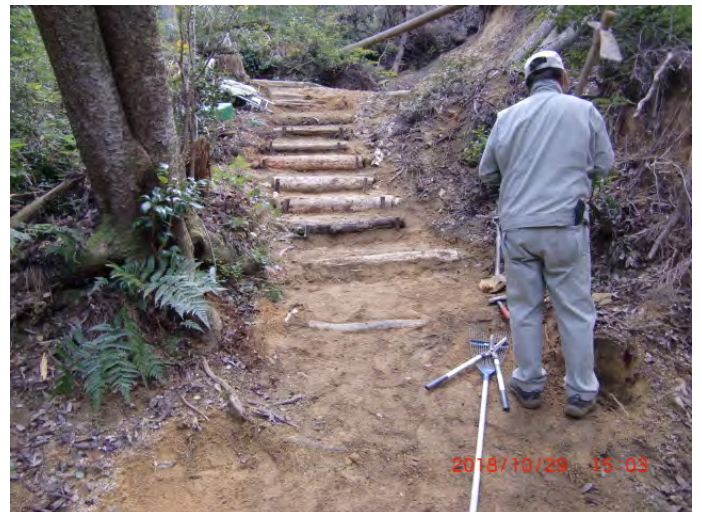
道の真ん中に大きな亀裂があり埋めて階段にしました
