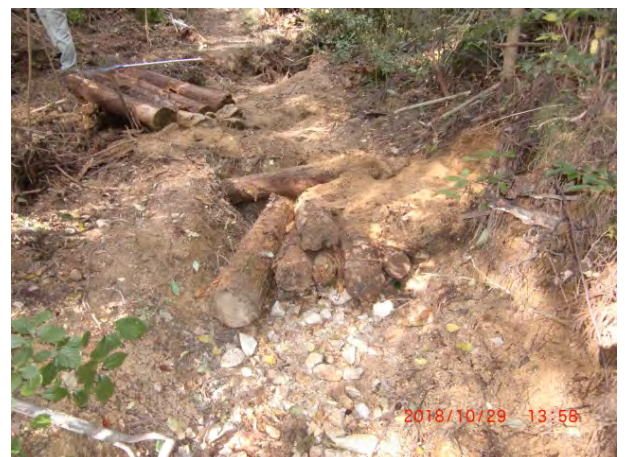
大きな陥没箇所があり、丸太を入れて平坦に
